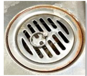
排水口に発生したバイオフィルム。茶色がかかった部分で、ぬめり状の物質
